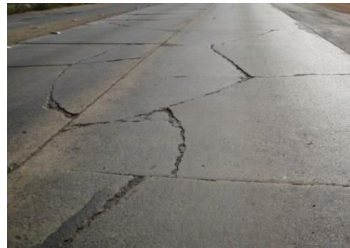
Figura 2. Fissuras lineares observadas nas placas de concreto da rodovia ERS-118, nas proximidades do Km 23.
