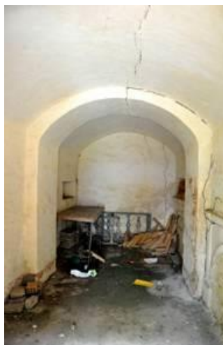
Figura 10. Fissura na abóbada.
