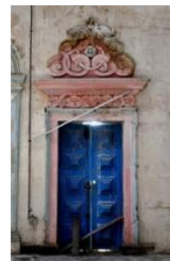
Figura 4. Cercadura de cantaria no interior da nave.
