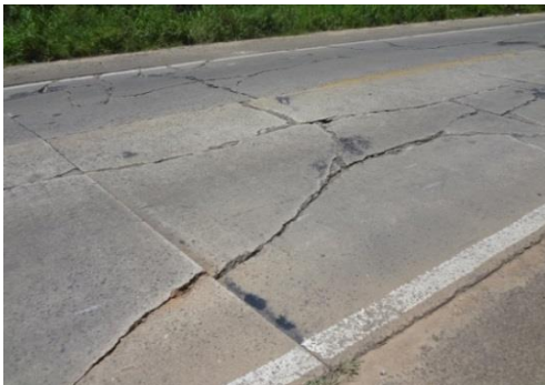
Figura 1. Fissuras lineares observadas nas placas de concreto da rodovia ERS-118, nas proximidades do Km 20.
