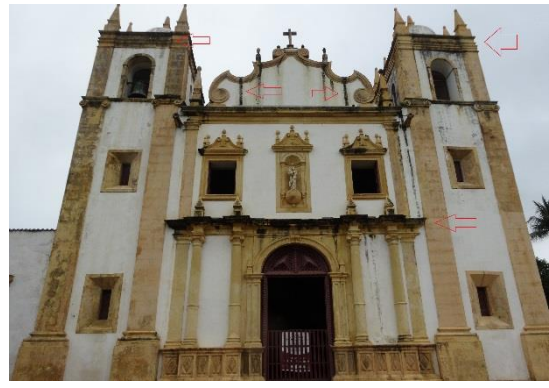
Figura 4. Danos atuais na Igreja do Carmo. Fonte: Autores.
