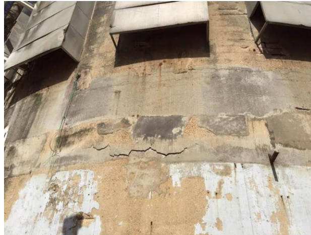
Figura 4. Detalhe de reparos localizados onde se observa a separação do concreto recente do anterior, o que provoca a delaminação das zonas de concreto de carácter anódico, que geram células de corrosão.
