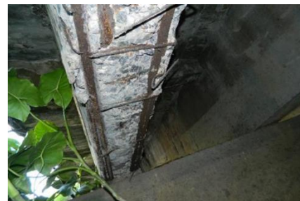
Figura 5. Armaduras expostas e oxidadas nas longarinas, exibindo inclusive estribos rompidos.
