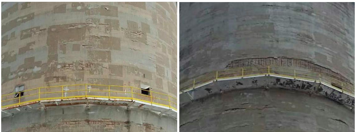
Figura 3. Observam-se armaduras expostas, corrosão, delaminações de concreto em forma de retângulos; Zonas de reparo localizadas realizadas anteriormente.
