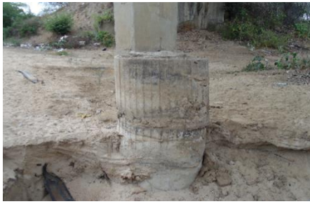
Figura 6. Erosão na fundação e grande excentricidade do pilar em relação ao tubulão.
