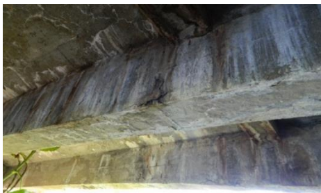
Figura 4. Presença de eflorescências, deslocamento do revestimento de concreto e manchas marrom-avermelhadas decorrentes do processo de corrosão das armaduras.
