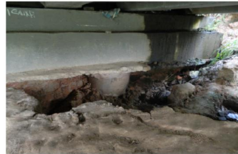
Figura 12. Presença de grande erosão na fundação.
