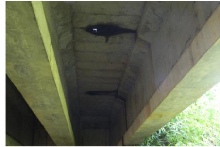
Figura 10. Dreno danificado provocando infiltração e manchas de umidade na laje entre longarinas
