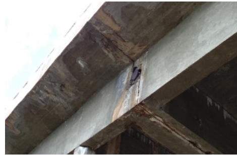
Figura 7. Aparelho de apoio metálico em um dente Gerber com visíveis danos e infiltrações.
