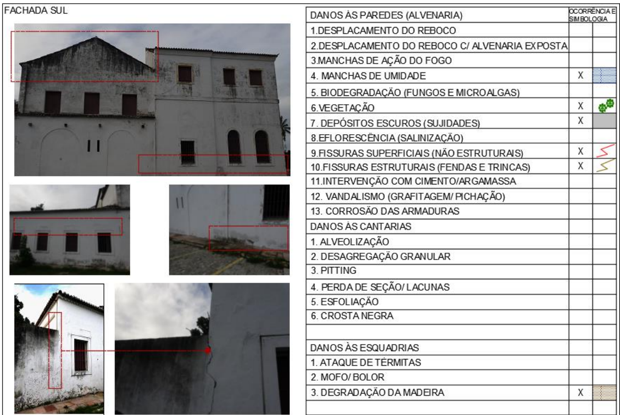
Figura 8. Ficha de Identificação de Danos da Fachada Sul da Igreja do Carmo. Fonte: Autores.
