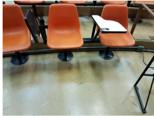
Figura 8. Charcos de agua formados por el goteo.
