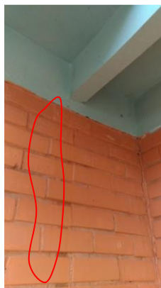
Figura 5. Drenaje de agua en la interfaz viga-mampostería
