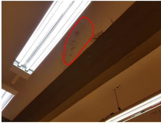
Figura 7. Resalte las manchas de humedad en el techo
