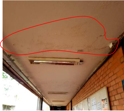
Figura 3. Canales en el revestimiento del techo del pasillo con moho, manchas de humedad y desprendimiento del revestimiento.
