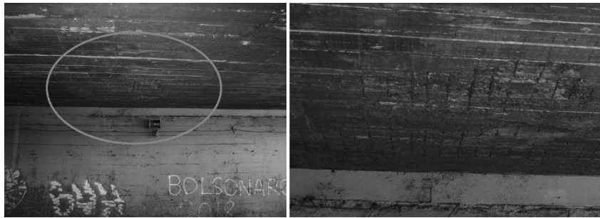
Figura 5. Cobrimento insuficiente e deterioração da Armadura
