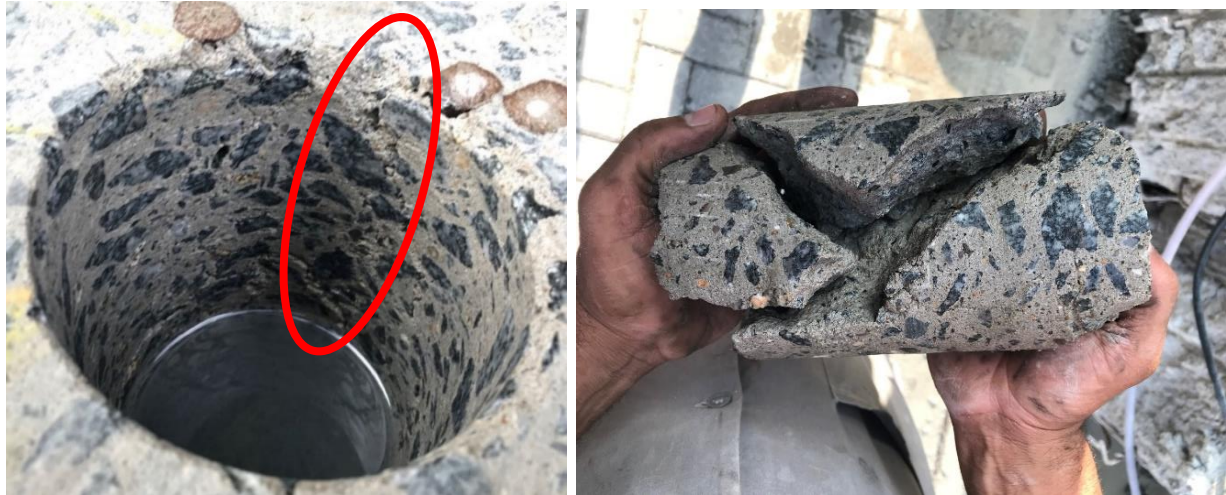
Figura 13. Fissuras visíveis durante a extração e testemunho descomposto. (fonte: acervo pessoal de Paulo Helene)
