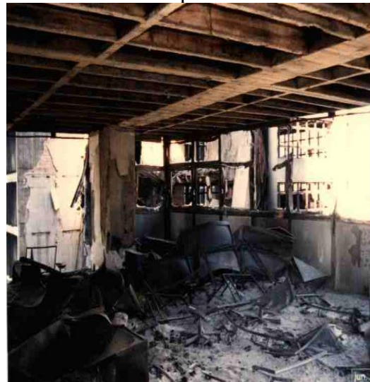
Figura 17. Estrutura do edifício Sede I danificada pelo incêndio
