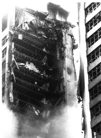
Figura 14. Detalhe da ruína da estrutura de concreto do edifício Sede II, mostrando as duas partes remanescentes da torre.
