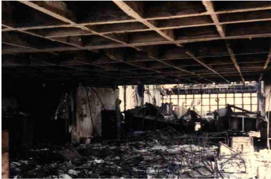
Figura 15. Vista da parte frontal da estrutura do edifício Sede II, a partir de sua parte posterior, com destaque para o vazio, deixado pelo desabamento da parte central
