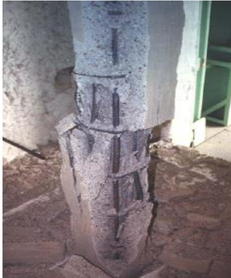
Figura 10. Exemplo de spalling explosivo ocorrido em pilar de concreto de alta resistência f_{ck} = 83 MPa (Kodur et al., 2005).
