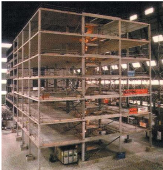
Figura 16. Perspectiva da estrutura protótipo em concreto armado concebida para o experimento de simulação de incêndio em Cardington (Chana & Price, 2003).
