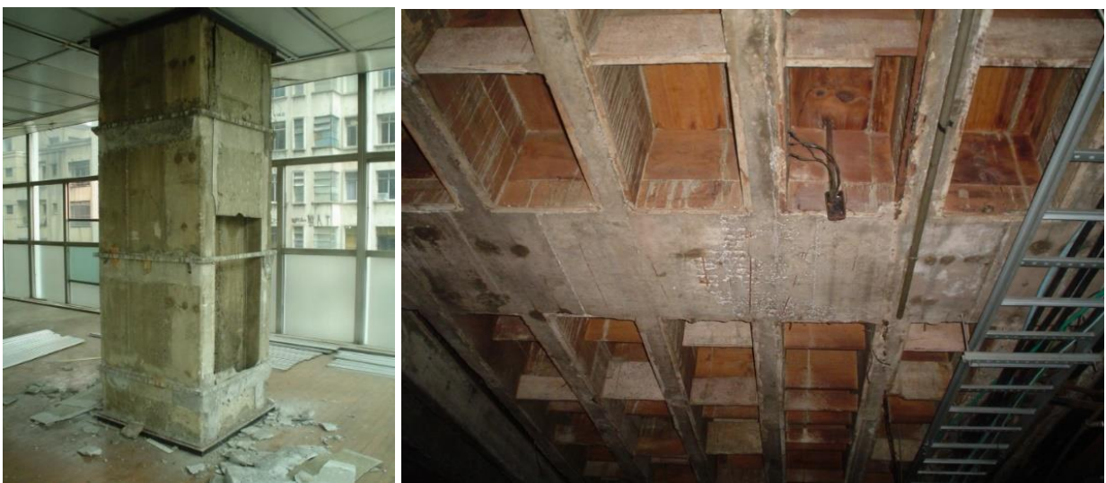
Figura 6. Pilar em concreto sem o revestimento metálico, onde se observa o “H” que na verdade é um shaft do ar condicionado e laje grelha com viga faixa ainda com as fôrmas de madeira. (fonte: acervo pessoal de Leandro Coelho)
