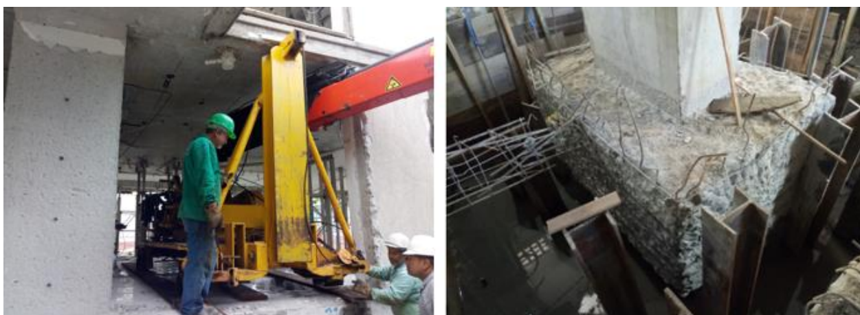
Figura 8. Detalhe da execução dos serviços de cravação (à esquerda) e das estacas metálicas cravadas no entorno do bloco de fundação a ser reforçado (à direita).
