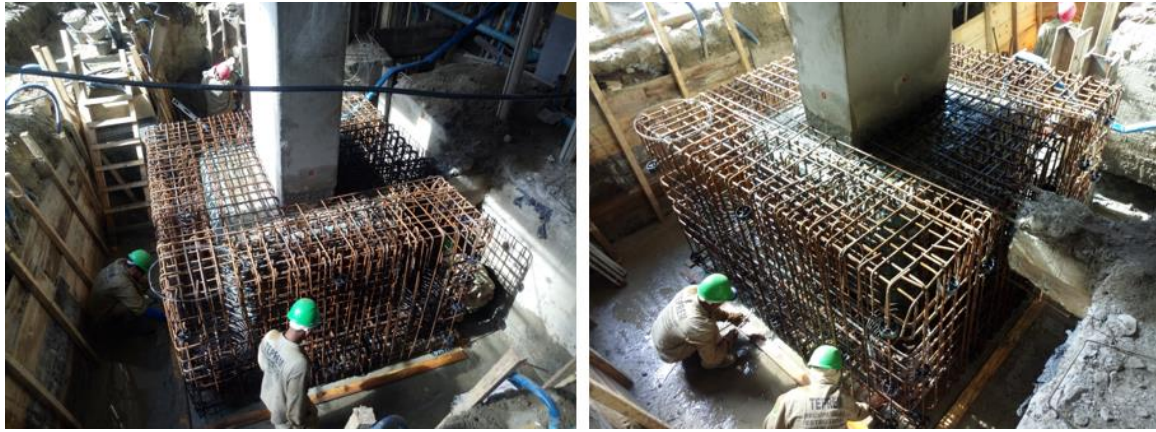
Figura 13. Detalhe da execução dos serviços de armação de reforço do bloco de fundação.
