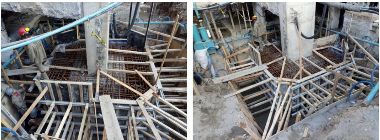
Figura 14. Detalle de las formas del refuerzo estructural de los encepados de fundación.
