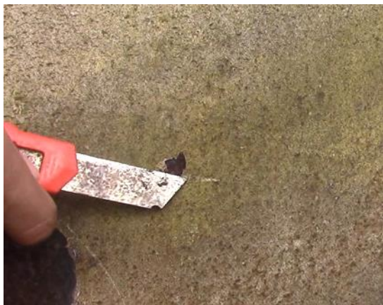
Figura 15. Daño mecánico en pintura de campo (Ribeiro Filho, 2018)
