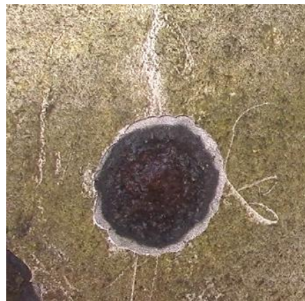
Figura 16. Zona limítrofe del área corroída sin corrosión (Ribeiro Filho, 2018)
