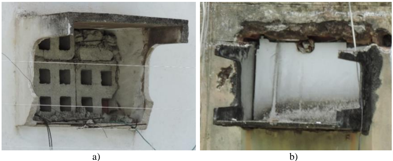
Figura 13. Ruptura parcial en el modelo de tipo de ventana, abierto: a) sin losa de fondo; b) sin losa superior
