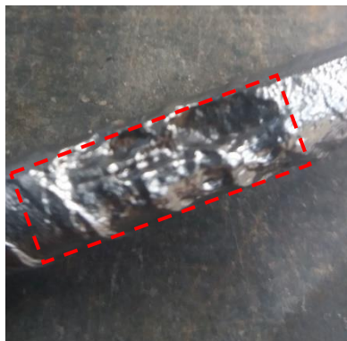
Figura 20. Perda de massa das barras de aço (L2).
