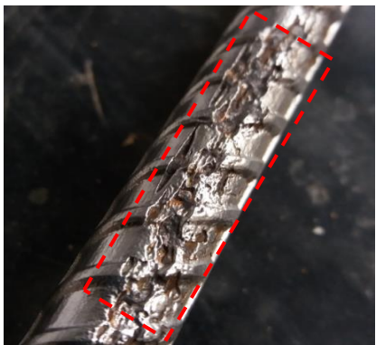
Figura 19. Perda de massa das barras de aço (L3).
