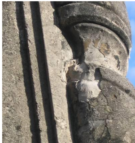
Figura 10. Intervenção inadequada. (Fonte: Arquivo da Equipe do Projeto de restauro do MNBA)
