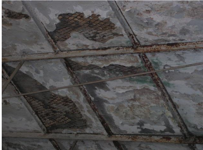
Figura 4. Aspecto da argamassa interna da cúpula Norte.
