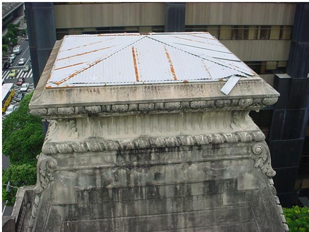
Figura 7. Cobertura metálica das cúpulas. (Fonte: Arquivo da Equipe do Projeto de restauro do MNBA)
