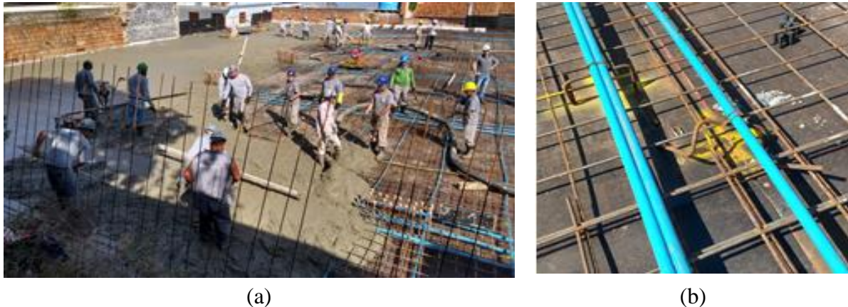
Figura 1. Operación de hormigonado: (a) Manejo de la mano de obra en contacto con la armadura. (b) Separador dañado y mal posicionado.
