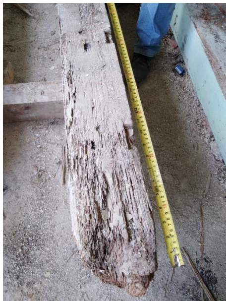
Figura 7. Medición con cinta métrica de la sección de viga afectada
