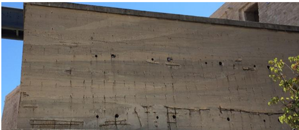
Figura 3. Corrosión inducida por carbonatación en zonas de escaso o inadecuado recubrimiento de concreto.
