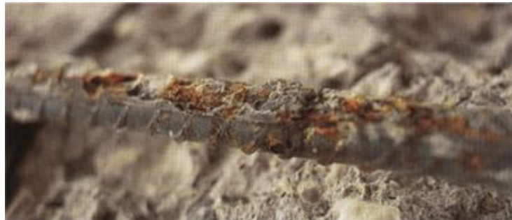
Figura 5. Corrosión típica inducida por picaduras de cloruro.
