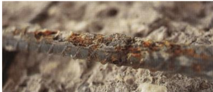
Figura 5. Corrosión típica inducida por picaduras de cloruro.
