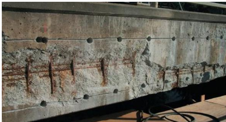
Figura 17. Ánodos discretos en el pretil de un puente.
