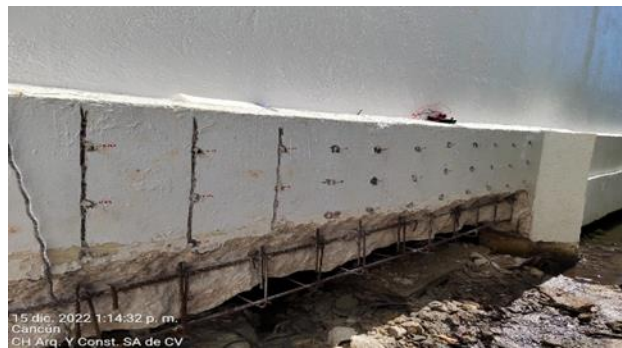
Figura 16. Instalación de ánodos dentro del concreto huésped con verificación de la instalación en Cancún, México.
