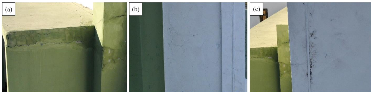
Figura 10. Manifestações patológicas da fachada oeste após 6 meses da revitalização: Fissuras, descasamento e eflorescência (a), Vesículas e fissuras mapeadas (b), Sujidades e descascamento.
