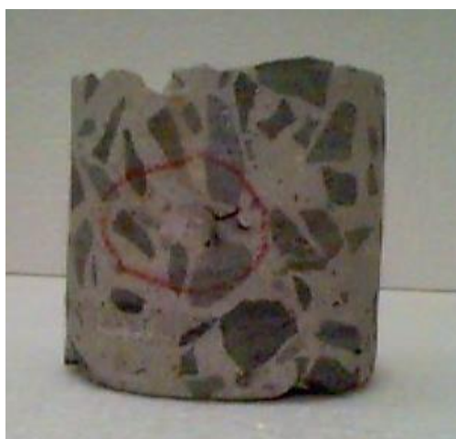
Figura 9. Detalhe dos vazios observados no corpo de prova extraído.
